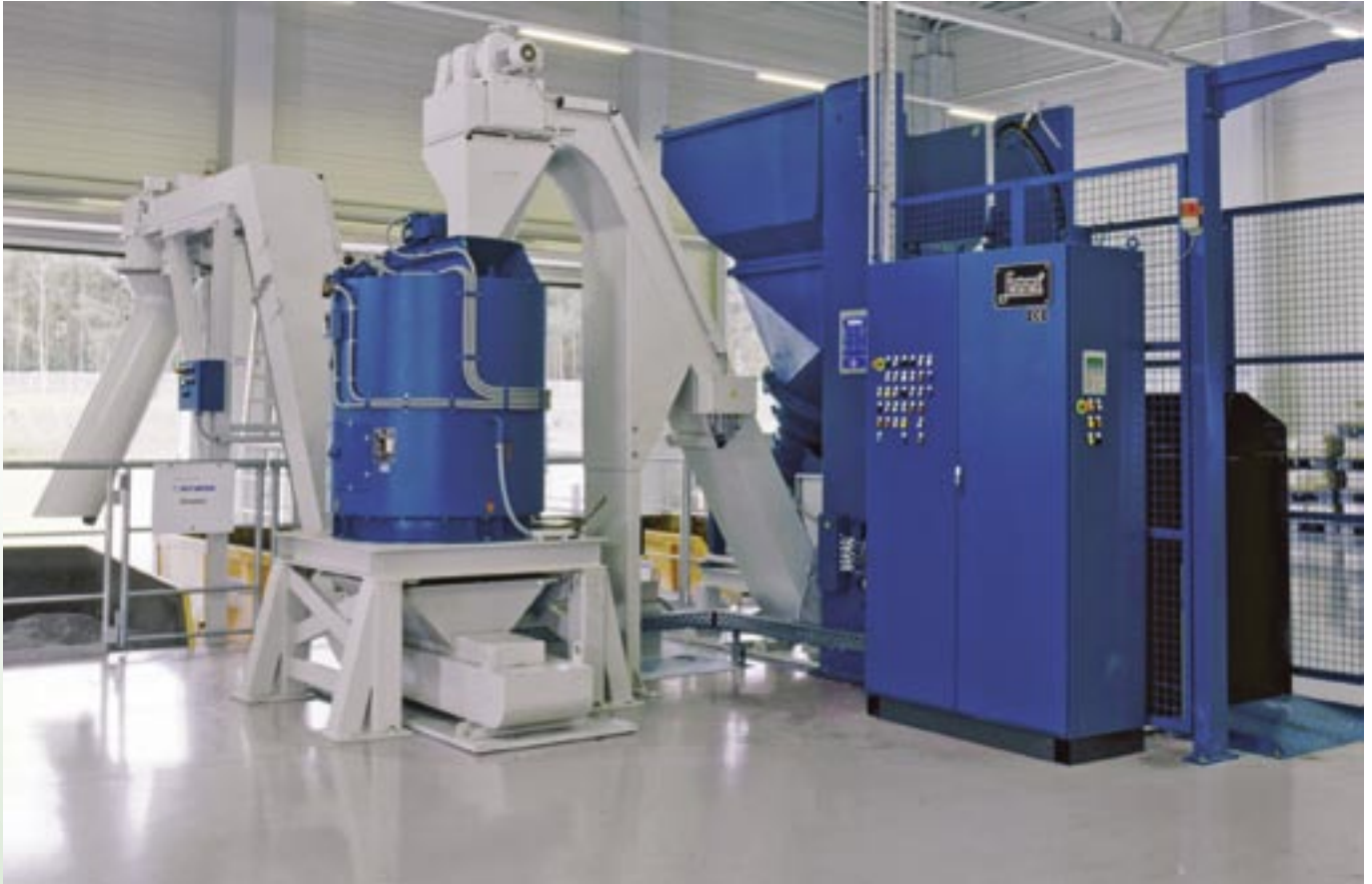
Permolex-Polar K51 en una instalación de tratamiento de virutas compuesta de: elemento de elevación y volqueo, molino de virutas RS 300 E, transportador rascador, centrifugadora Permolex-Polar K51, transportador rascador con tubo giratorio para la descarga en contenedores a aportar por el cliente.
